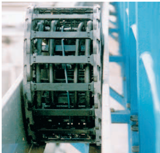
Verfahrweg von 195 m mit dem igus® System E4, sicher geführt in einer igus® Stahl Führungsrinne
